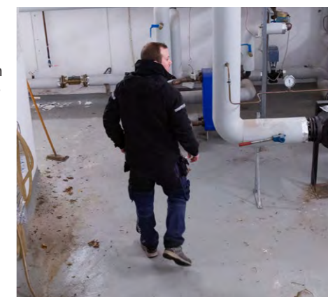
SÅ HÄR KAN EN AV VÅRA UNDERCENTRALER SE UT DÄR ALLT VARTM VATTEN PUMPAS UT TILL RADIATORERNA I Huset.
